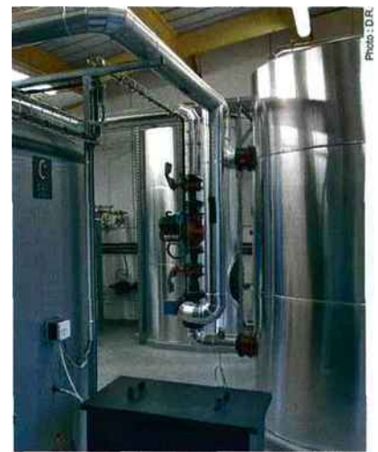
La société CEL, filiale d'Hervé Thermique, a installé une chaudière bois à la chambre d'agriculture.
